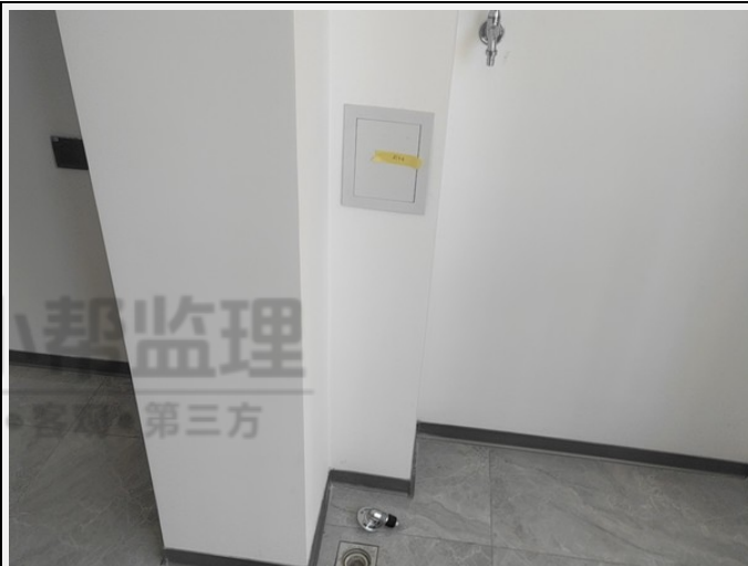
6、阳台检修口，无法正常弹出
