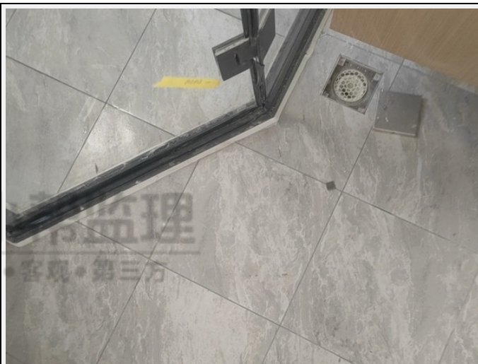
4、玻璃门密封条脱落
